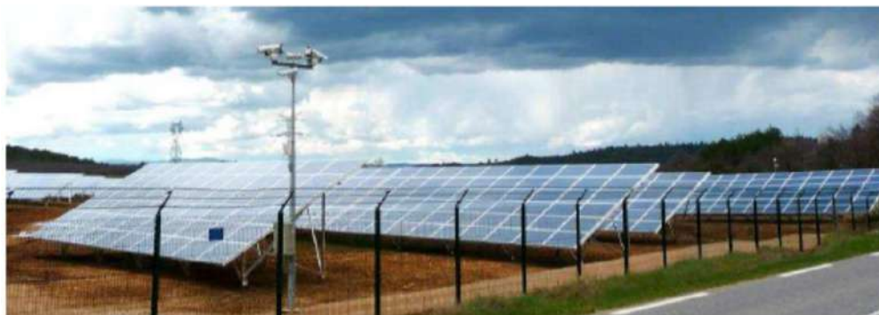
Figure 26 : Exemple de clôture et système de surveillance par caméras
