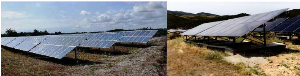
Figure 13 : Exemple de centrale photovoltaïque équipée de panneaux fixes – technologie cristalline (couche épaisse)
