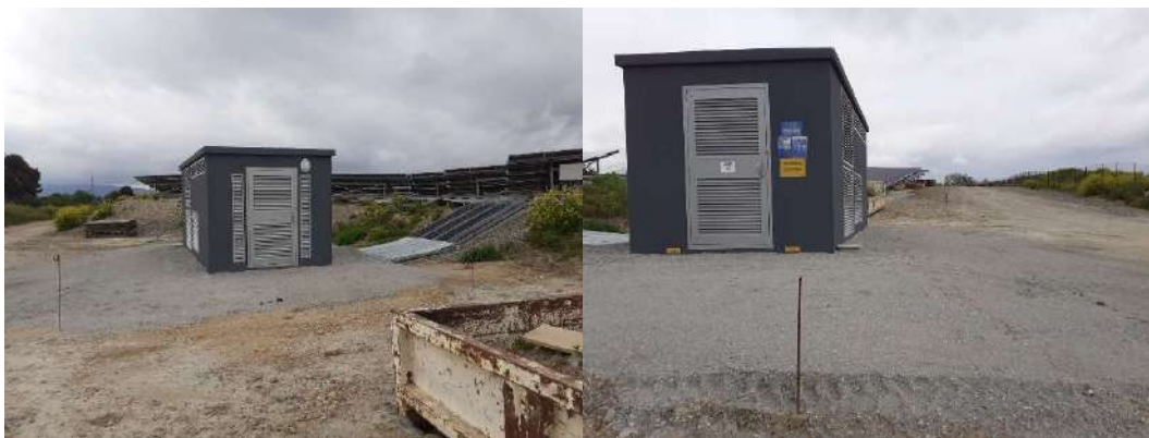
Figure 20 : Exemple de poste de transformation
