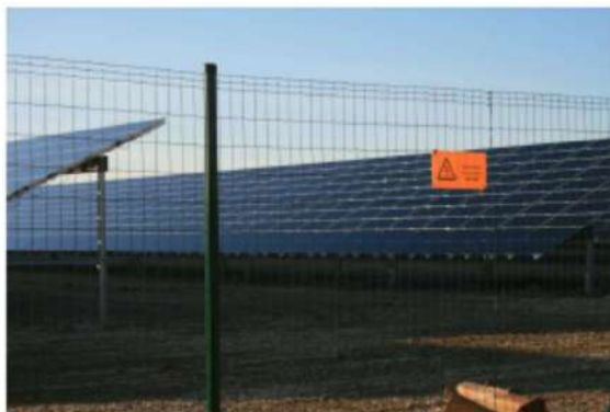
Figure 30 : Clôture grillagée autour d'une centrale solaire photovoltaïque
